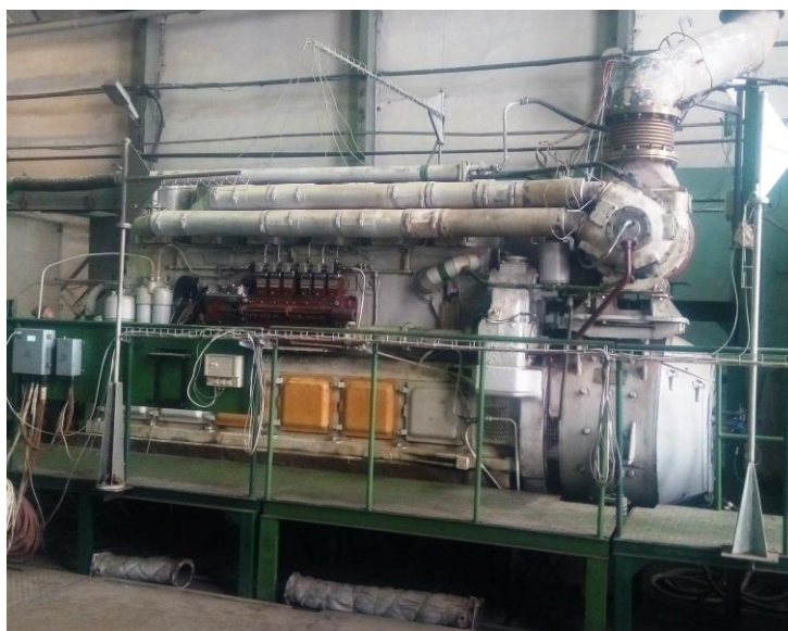
Рисунок 6.1 - Общий вид стендового дизель-генератора 1-ПДГ4Д с ЭСУВТ.01
